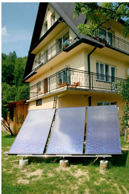
↑ Różne sposoby zamontowania kolektorów – zawsze zgodnie z wytycznymi. Można ustawić kolektor poza obrysem budynku, ale musi się znaleźć na prefabrykowanym postumencie
